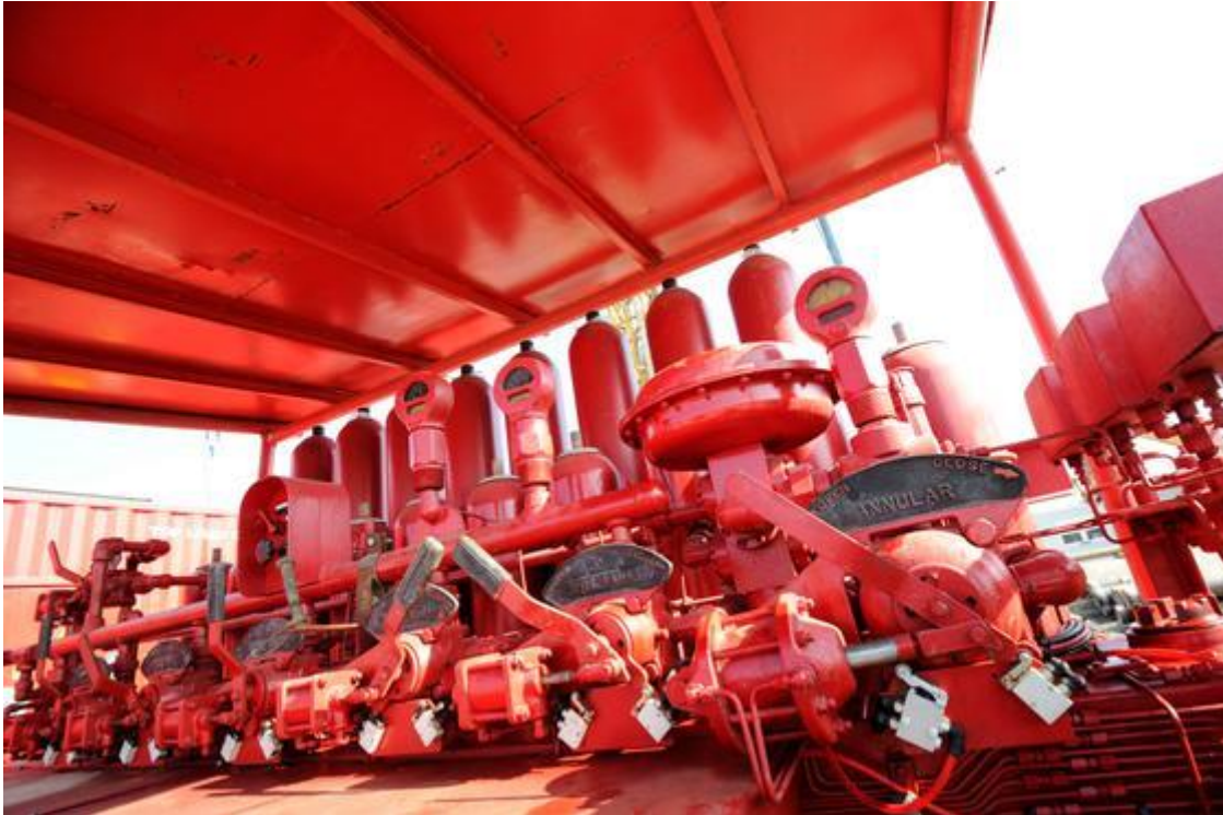
Die Pumpanlage fördert Wasser. (Bild: Donato Caspari, 9. März 2011)
