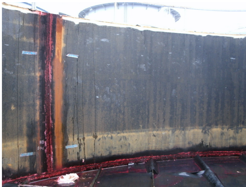
Immer wieder treten in den Tanks von Fukushima Lecks auf. Auch diese Woche wurden wieder zwei gefunden. Die Betreiber-Firma Tepco versucht, die Löcher zu stopfen. (Foto: Tepco)
